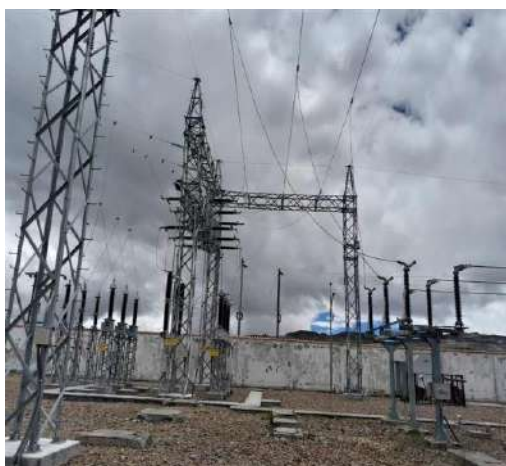
SET CAUDALOSA 60 kV
