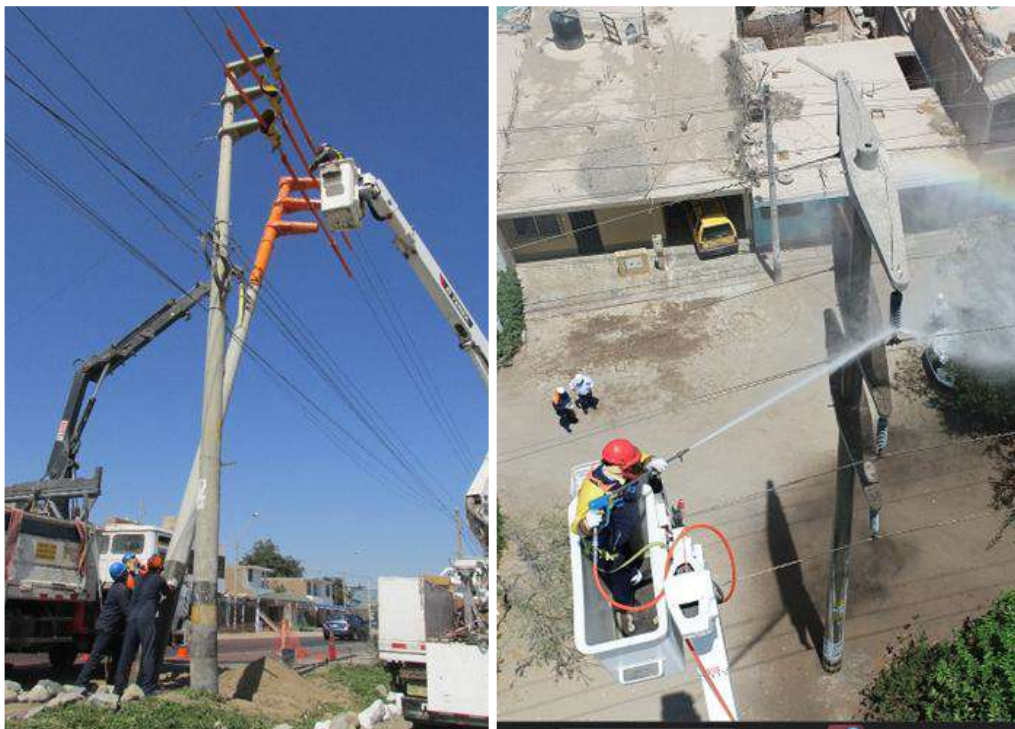
Lavado en línea de AT
