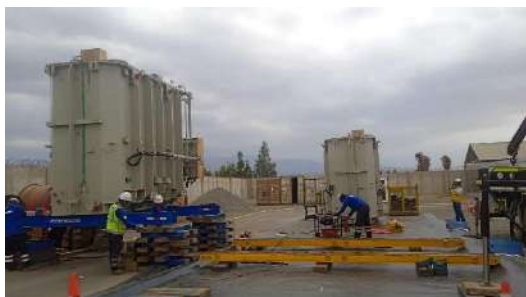
Recepción de Banco de Transformadores 40MVA 220/60/10kV
