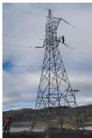
Torres de Celosía 60 KV
