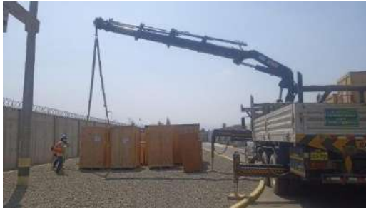
Recepción de celdas de Media Tensión en 10kV
