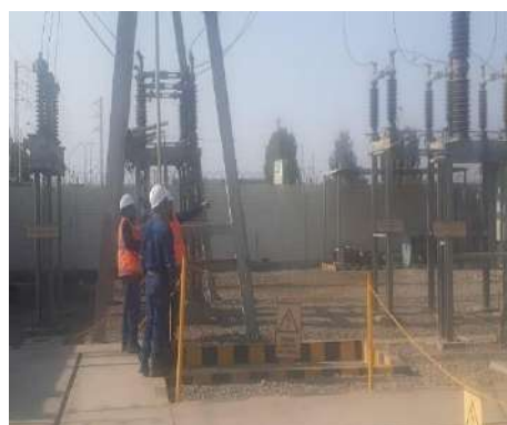
Inspección en Set Alto la Luna – Bahía provisional de 60kV L6605-01
